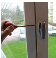
Indication des défauts d'étanchéité avec une poire à fumée
